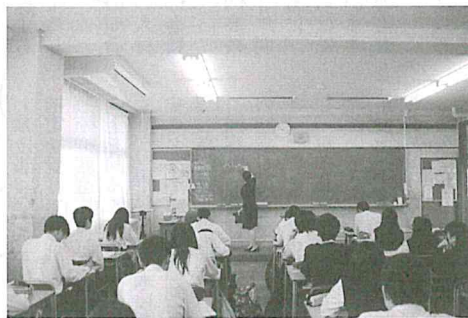
教室前方窓側に設置されたエアコン
